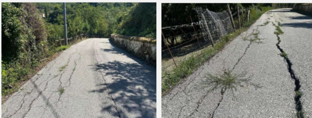
STATO DI FATTO DELLA STRADA DI VIA CERRETO E DEL VERSANTE A VALLE DELLA PIATTAFORMA STRADALE
