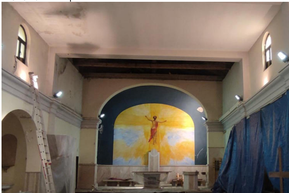
FOTO 10 - Stato prima dei lavori con arte del controsoffitto crollato
