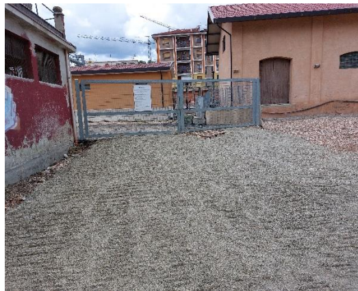
Messa a nudo delle murature al PT Area esterna - Fondazione futura recinzione
