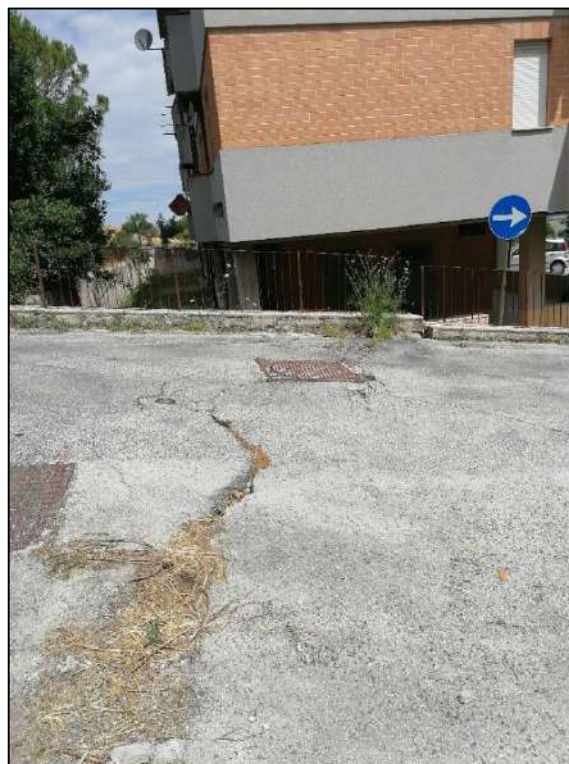
FOTO 3 – DEFORMAZIONE DELLA STRADA DI ACCESSO IN CORRISPONDENZA DEI SOTTOSERVIZI A RETE
