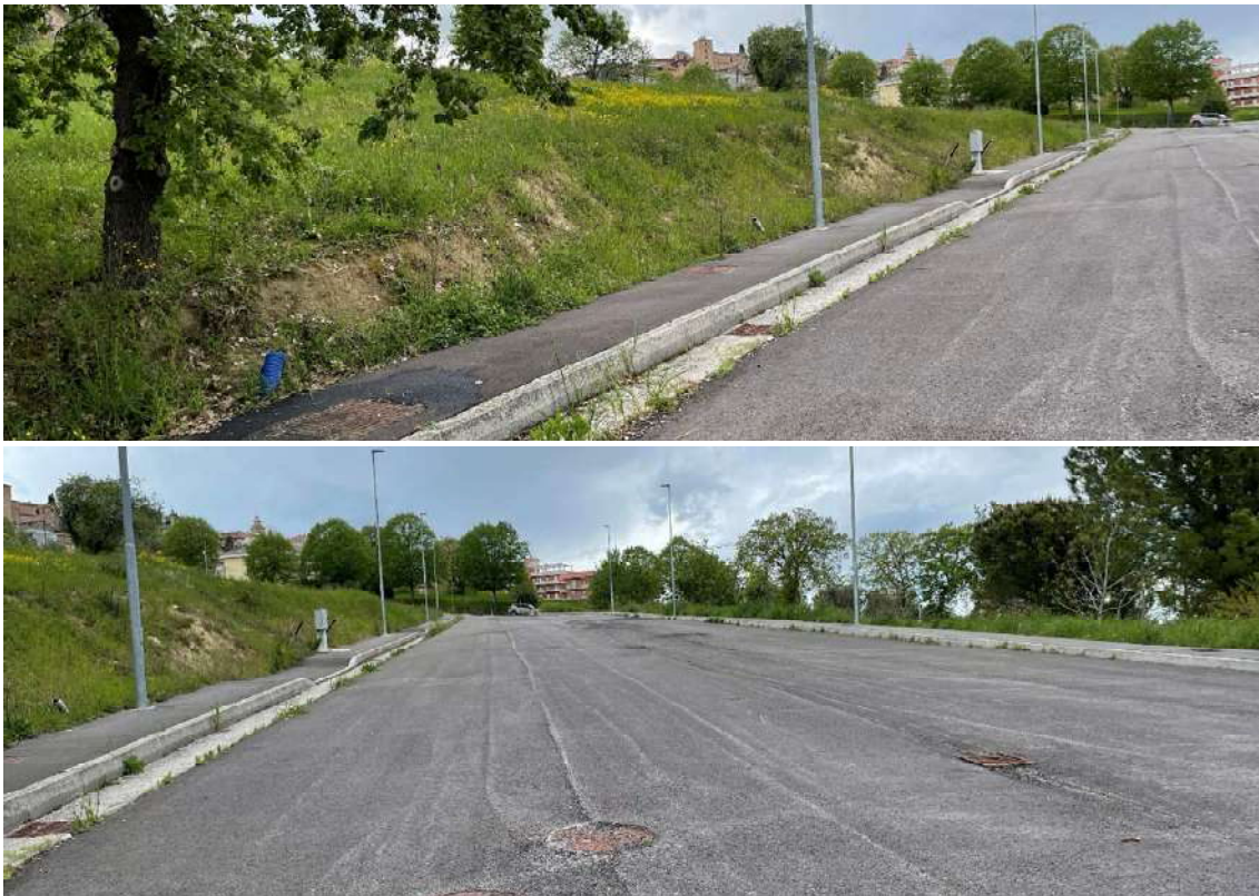
Figura 7.6. In alto: tagli antropici sulle colluvioni per la realizzazione della strada di accesso all'area; in basso: assenza di lesioni sull'intero manto stradale nonostante la presenza di terreno di riporto sul lato sinistro stante una sezione a mezza costa della strada
