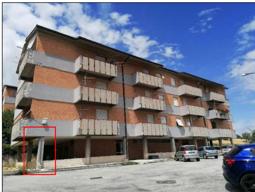
FOTO 9 – PALAZZINA “C” VISTA ANTERIORE. IN EVIDENZA PILASTRO D’ANGOLO CON COPRIFERRO AMMALORATO
