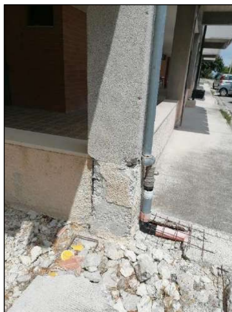
FOTO 10 – PARTICOLARE DEL COPRIFERRO DEL PILASTRO D’ANGOLO DELLA PALAZZINA “C”.
