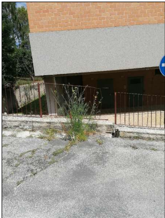
FOTO 4 – DEFORMAZIONE DEL MURETTO LUNGO LA STRADA DI ACCESSO ALLE QUATTRO PALAZZINE
