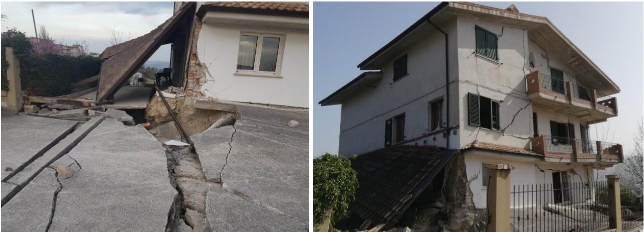
Foto 6 effetti della frana sugli edifici
