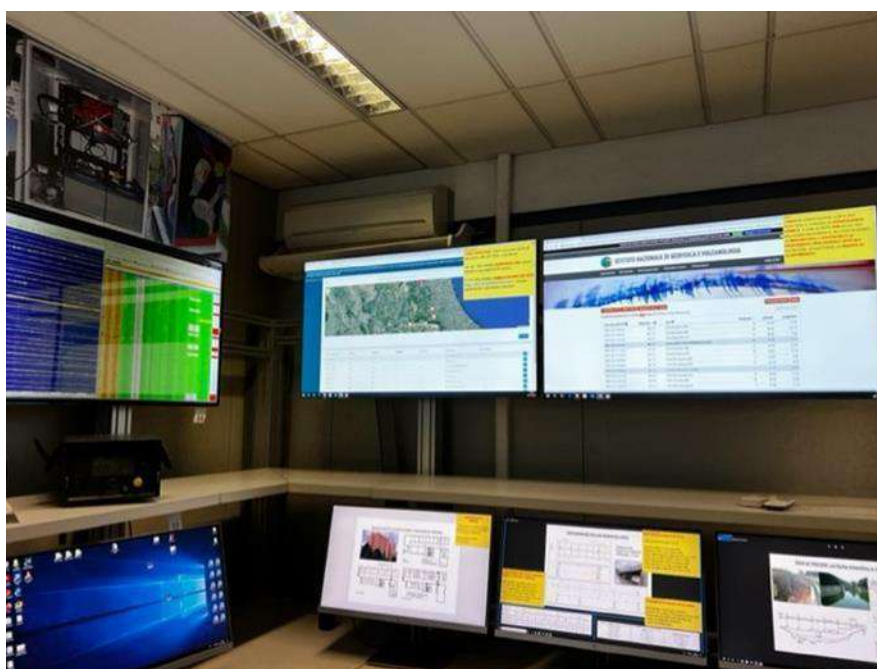
Figura 2 – Control room eventi sismici DPC sede Via Vitorchiano 4, Roma
