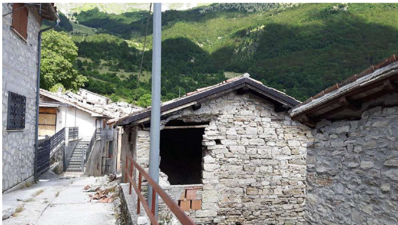
2. Foto stato di fatto Post Sisma ed Ante Demolizioni Frazione
