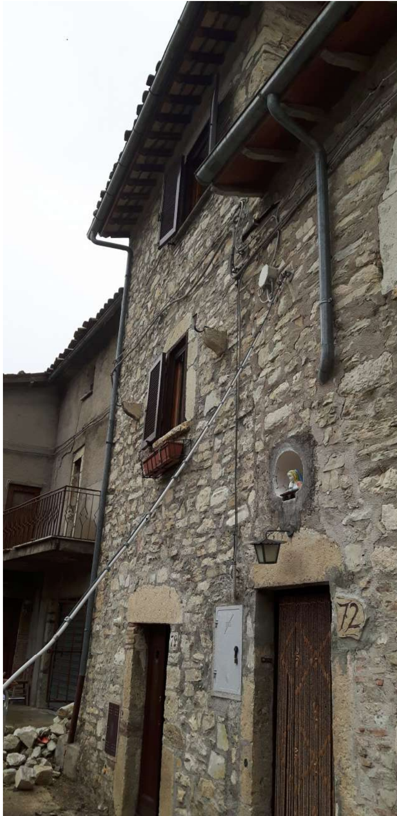
1. Foto stato di fatto Post Sisma ed Ante Demolizioni Frazione
